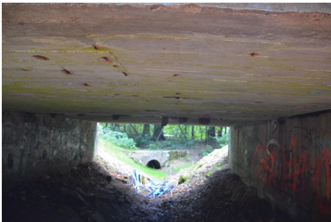
Fot. 12. Zaawansowana korozja betonu, zbrojenie pozbawione otuliny, zaawansowana korozja zbrojenia
