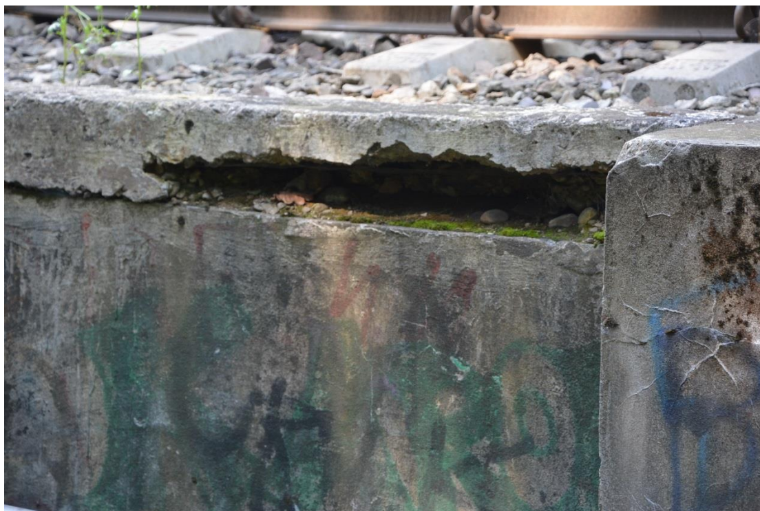
Fot. 7. Widok nadbudowy gzymsu przęsła w miejscu ubytku brak widocznego zbrojenia, nieregularne, poziome rysy na skrzydełku, korozja betonu, ubytki betonu
