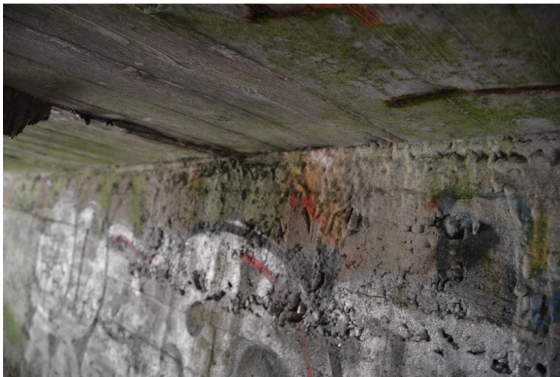
Fot. 10. Zaawansowana korozja betonu, zbrojenie pozbawione otuliny, korozja zbrojenia, nieszczelna izolacja i dylatacja poprzeczna mostu powodująca zawilgocenie płyty i przyczółka
