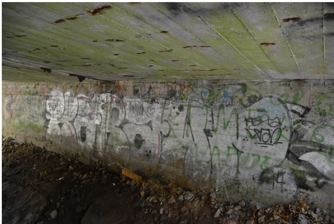
Fot.6. Widok przyczółka, korozja betonu, nieszczelna izolacja i dylatacja poprzeczna mostu powodująca zawilgocenie płyty i przyczółka
