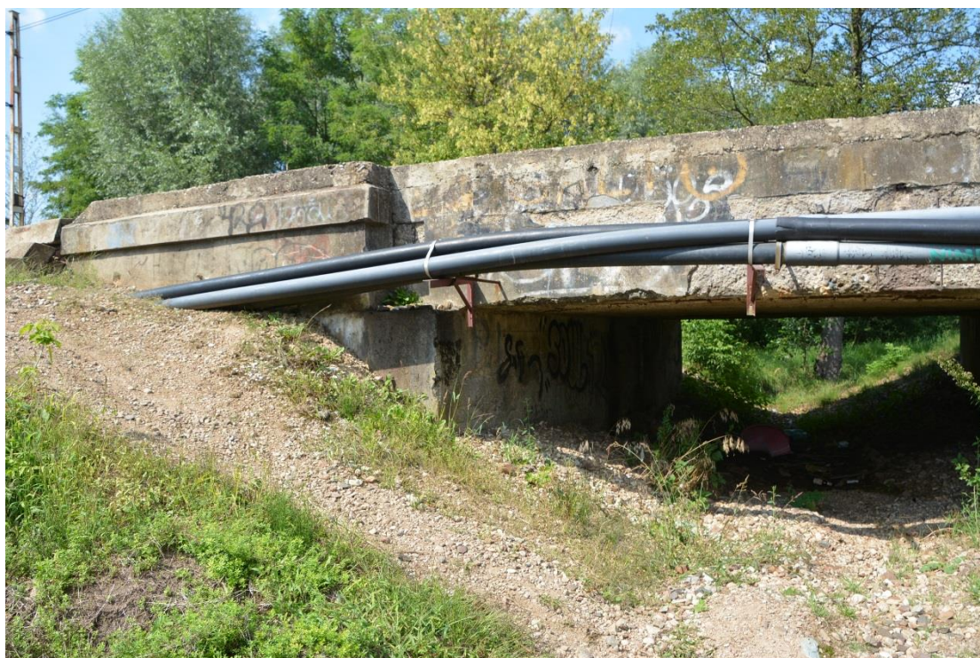
Fot. 8. Widok przyczółka od strony Grodziska Mazowieckiego, korozja betonu, ubytki betonu na krawędzi płyty, zbrojenie pozbawione otuliny, korozja zbrojenia
