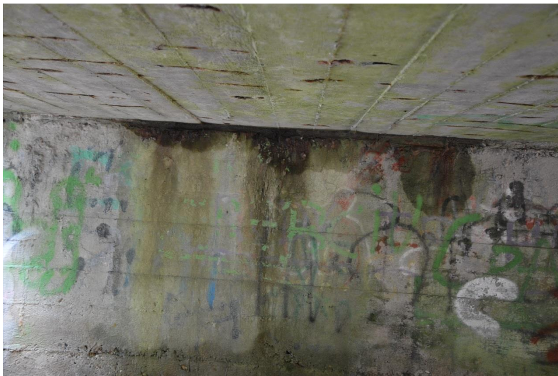
Fot. 8. Widok przyczółka, korozja betonu, korozja biologiczna, ubytki betonu nadbudowy gzymsu w miejscu ubytku brak widocznego zbrojenia
