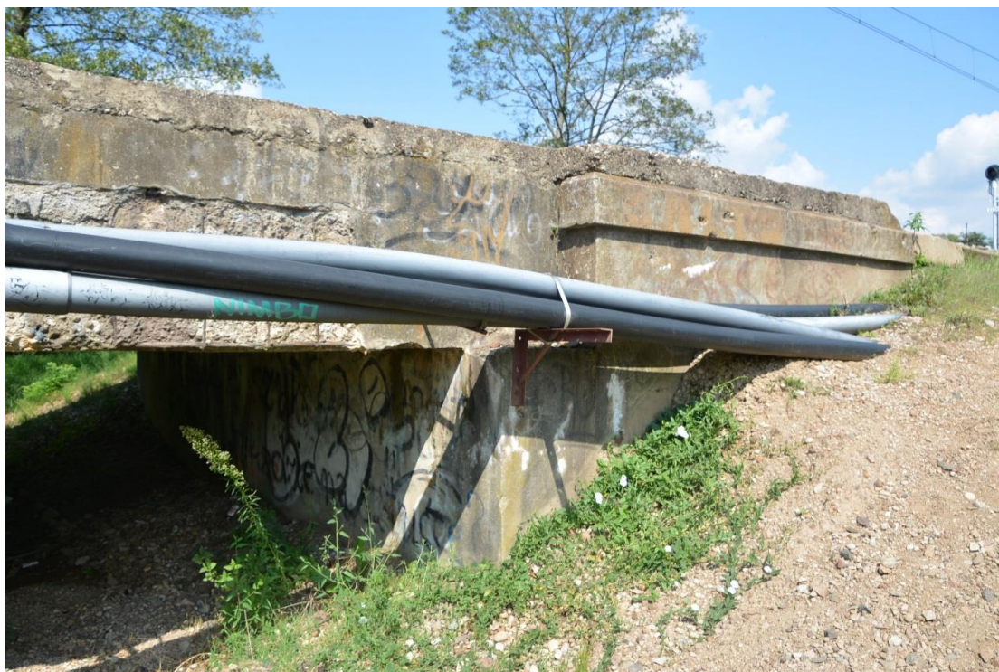
Fot. 7. Widok przyczółka od strony Warszawy, korozja betonu, ubytki betonu na krawędzi płyty
