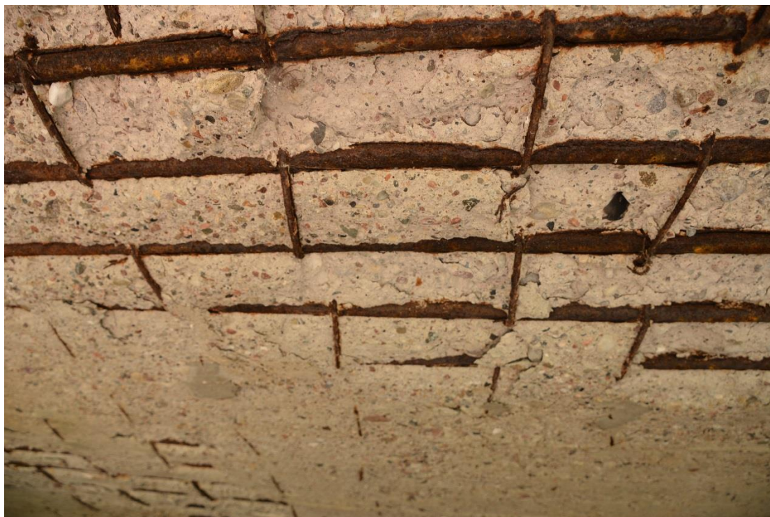
Fot. 9. Zaawansowana korozja betonu, zbrojenie pozbawione otuliny, zaawansowana korozja zbrojenia
