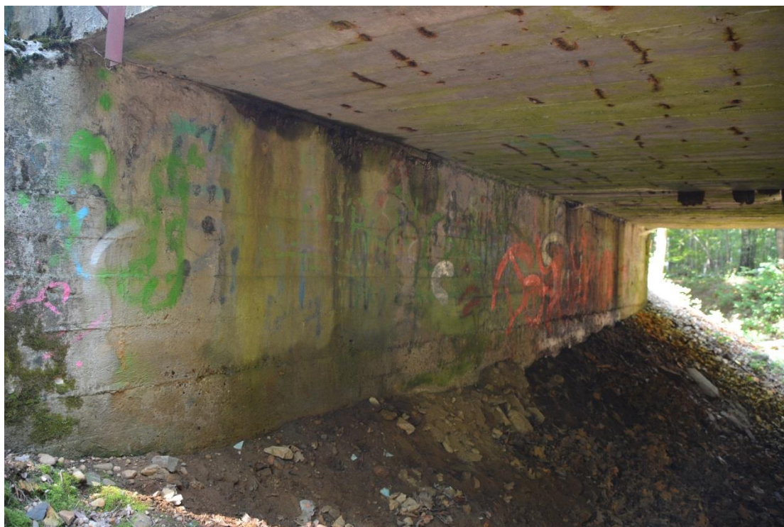
Fot. 5. Widok przyczółka, korozja betonu, ubytki betonu nadbudowy gzymsu przęsła, nieszczelna izolacja i dylatacja poprzeczna mostu powodująca zawilgocenie płyty i przyczółka
