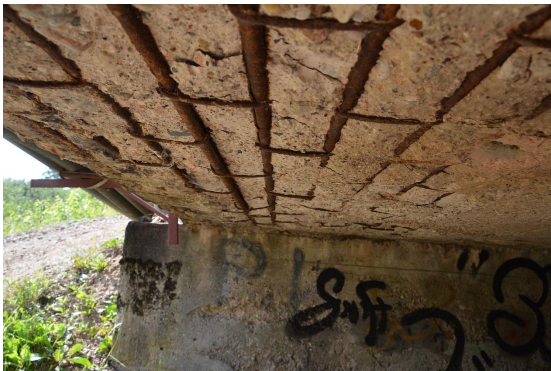
Fot. 12. Widok przęsła od strony toru nr 2, zaawansowana korozja betonu, zbrojenie pozbawione otuliny, zaawansowana korozja zbrojenia
