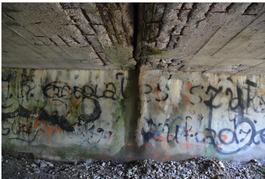
Fot. 10. Widok dylatacji podłużnej, zaawansowana korozja betonu, zbrojenie pozbawione otuliny, zaawansowana korozja zbrojenia, nieszczelna izolacja i dylatacja podłużna i poprzeczna mostu powodująca zawilgocenie płyty i przyczółka, wykwit i nacieki spowodowane wypłukiwaniem składników betonu
