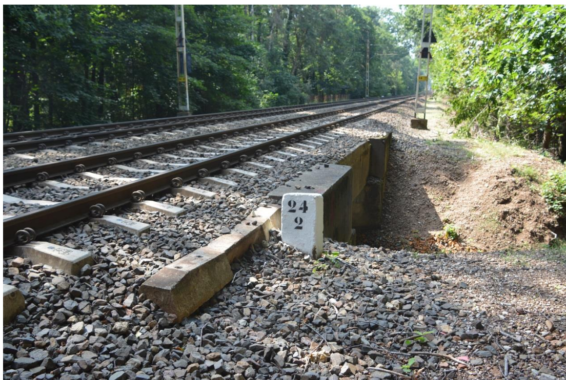
Fot. 4. Widok nawierzchni kolejowej na moście i dojazdach, obsypujący się tłuczeń za przyczółkiem
