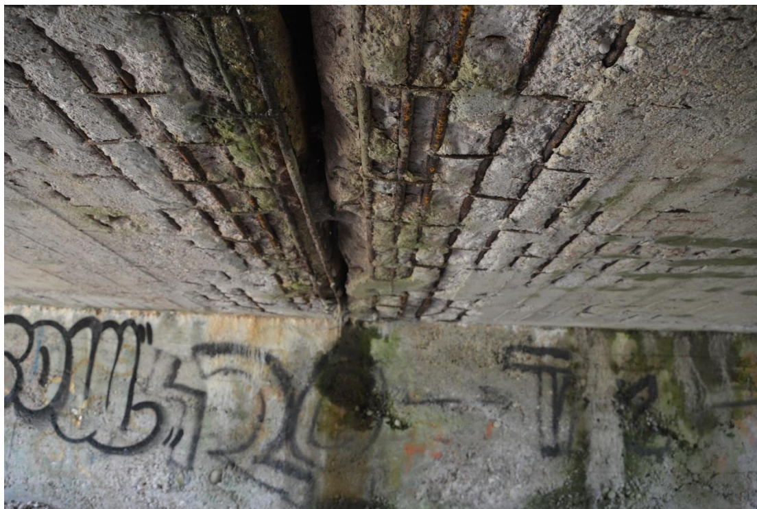
Fot. 11. Zaawansowana korozja betonu, zbrojenie pozbawione otuliny, zaawansowana korozja zbrojenia, nieszczelna izolacja i dylatacja poprzeczna mostu powodująca zawilgocenie płyty i przyczółka, wykwyty i nacieki spowodowane wypłukiwaniem składników betonu
