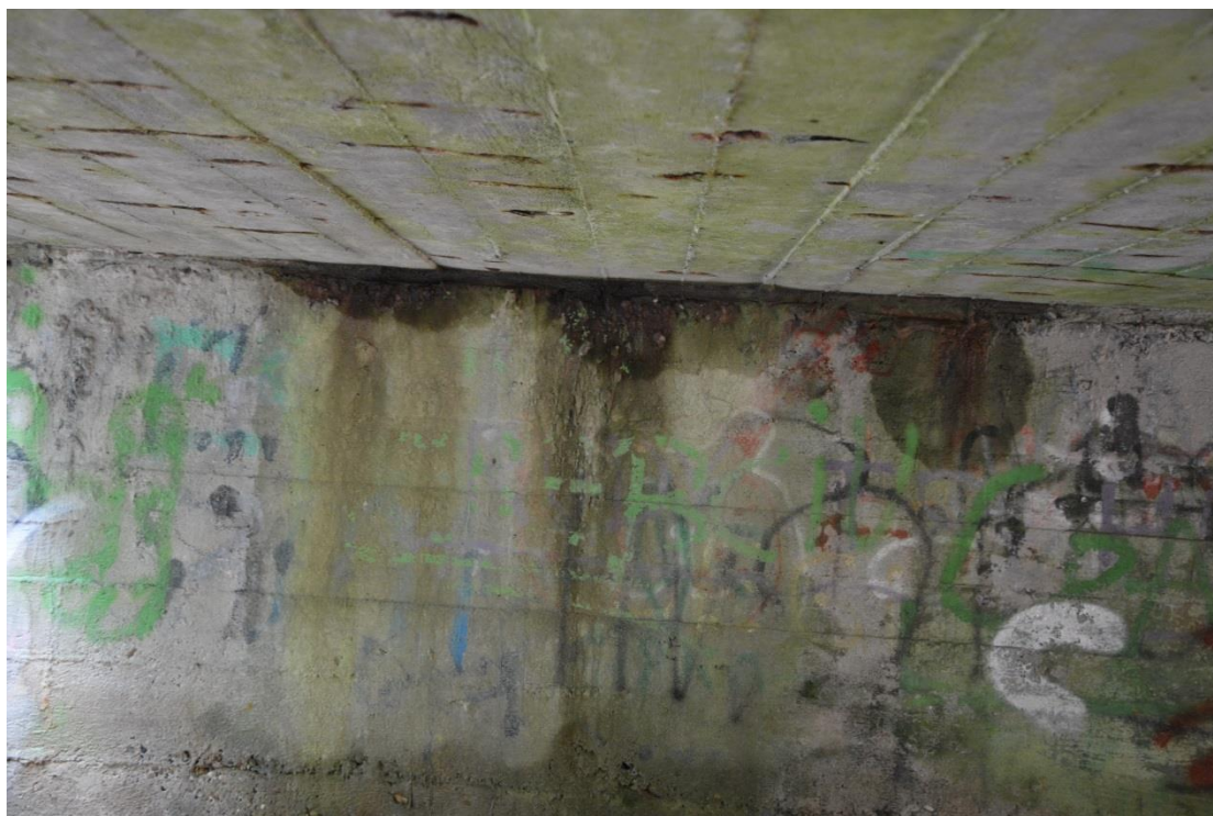
Fot. 11. Zaawansowana korozja betonu, zbrojenie pozbawione otuliny, zaawansowana korozja zbrojenia, nieszczelna izolacja
